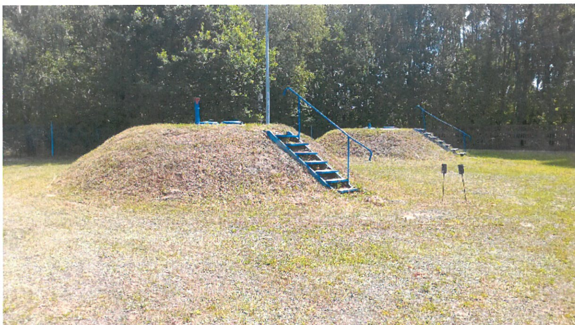
Zdjęcie nr 2 – Widok na studnie głębinowe.
