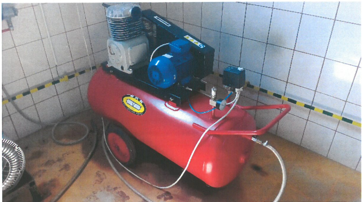
Zdjęcie nr 4 – Sprężarka olejowa.
