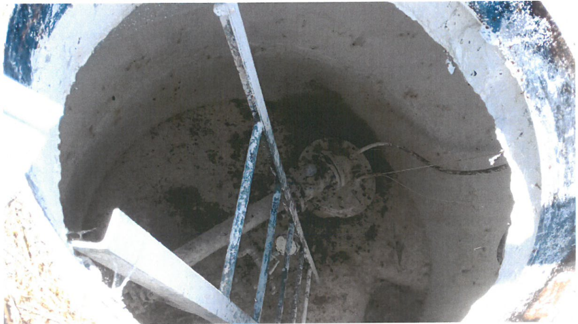
Zdjęcie nr 11 – Widok wnętrza studni głębinowej Nr 2.
