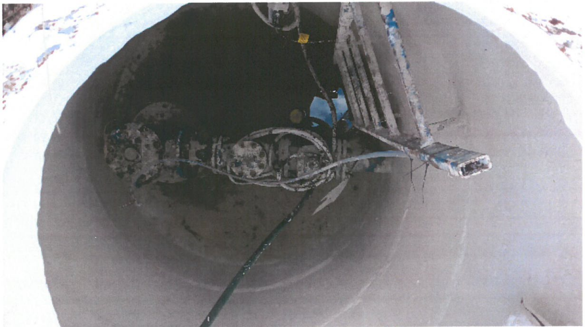
Zdjęcie nr 4 – Widok wnętrza studni głębinowej Nr 2.
