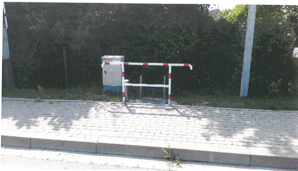
Zdjęcie nr 57 – Pompownia.
