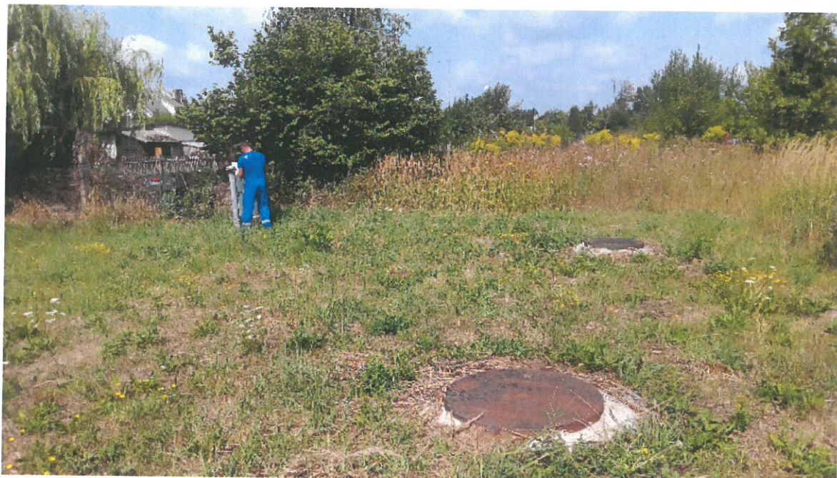
Zdjęcie nr 55 – Pompownia.
