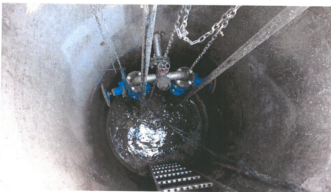
Zdjęcie nr 58 – Pompownia.
