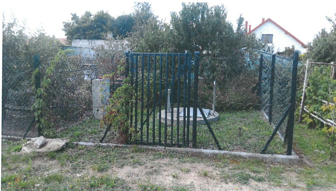
Zdjęcie nr 39 – Pompownia.
