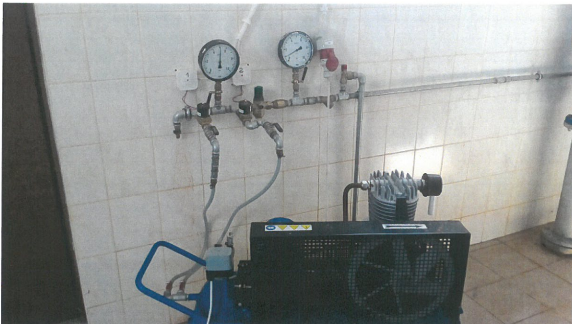
Zdjęcie nr 12 – Sprężarka olejowa.
