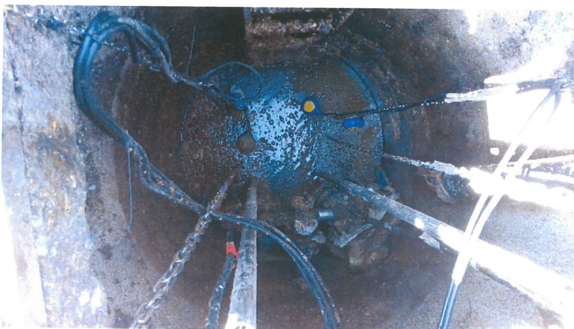
Zdjęcie nr 52 – Pompownia.
