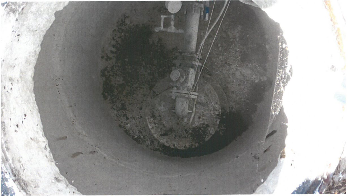
Zdjęcie nr 10 – Widok wnętrza studni głębinowej Nr 1.
