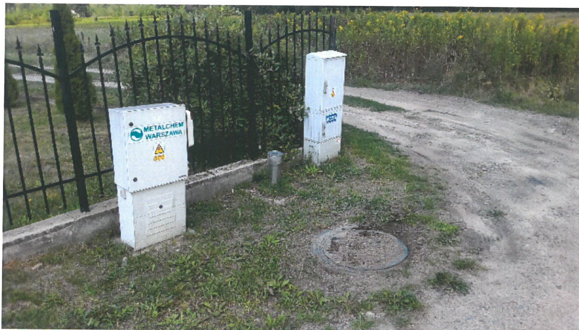
Zdjęcie nr 47 – Pompownia.
