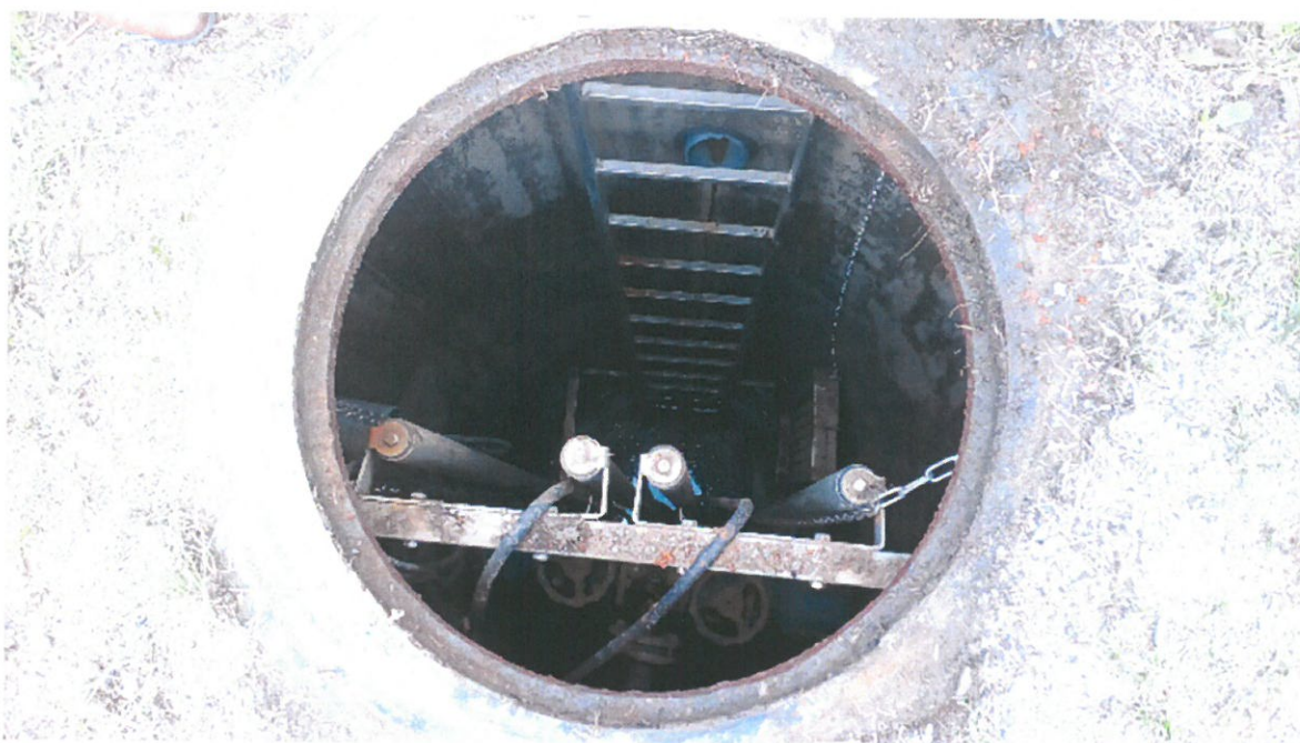
Zdjęcie nr 48 – Pompownia.
