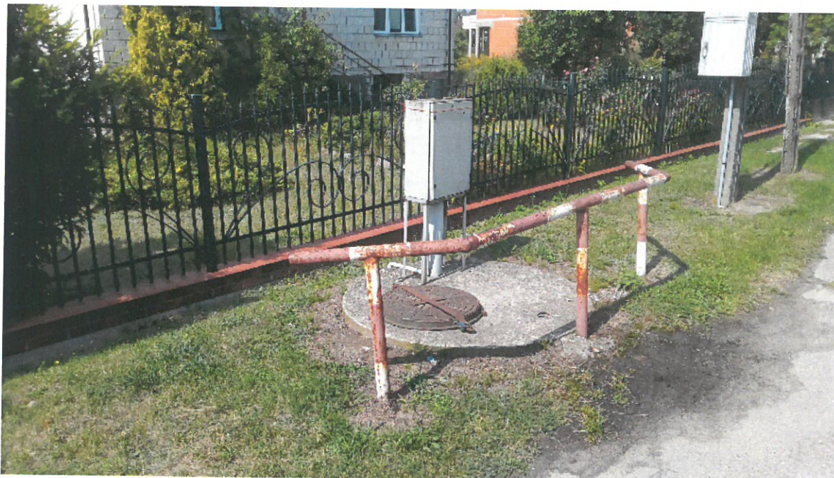
Zdjęcie nr 53 – Pompownia.
