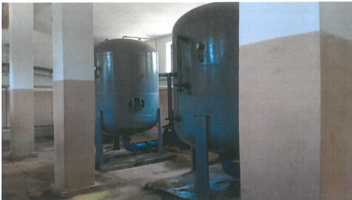
Zdjęcie nr 31 – Zbiorniki hydroforowe.
