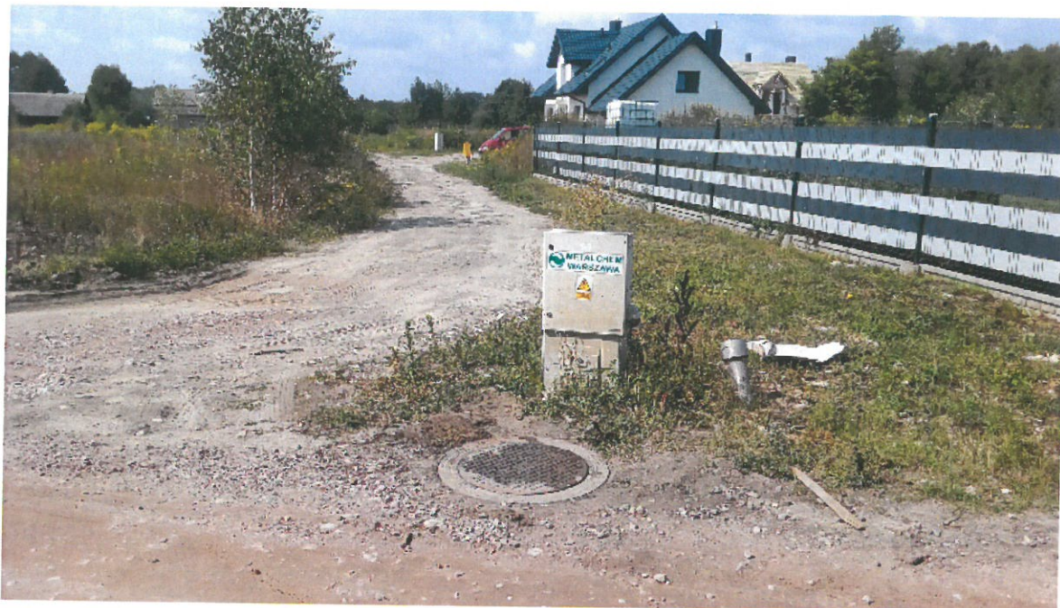
Zdjęcie nr 49 – Pompownia.
