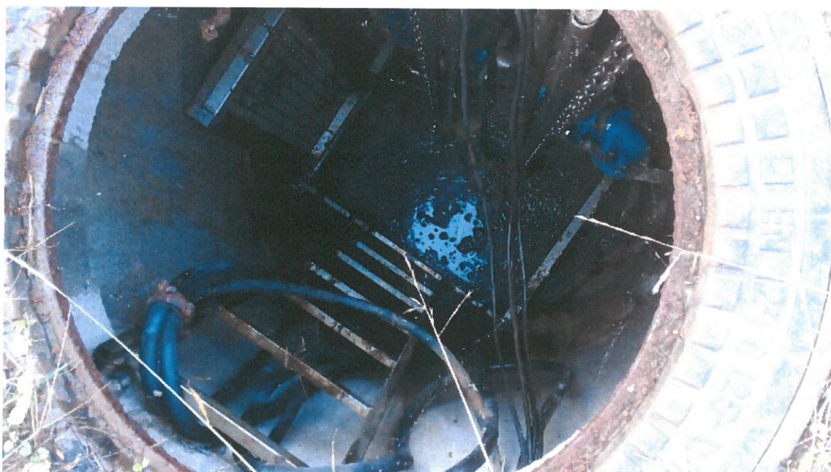
Zdjęcie nr 42 – Pompownia.
