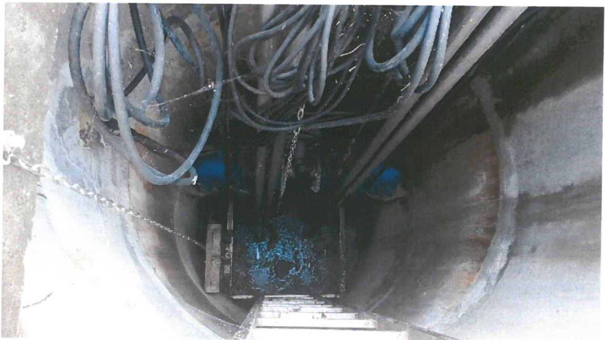
Zdjęcie nr 44 – Pompownia.
