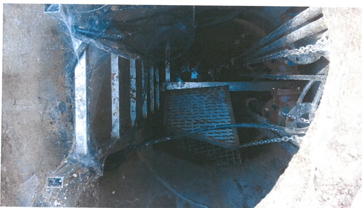
Zdjęcie nr 54 – Pompownia.
