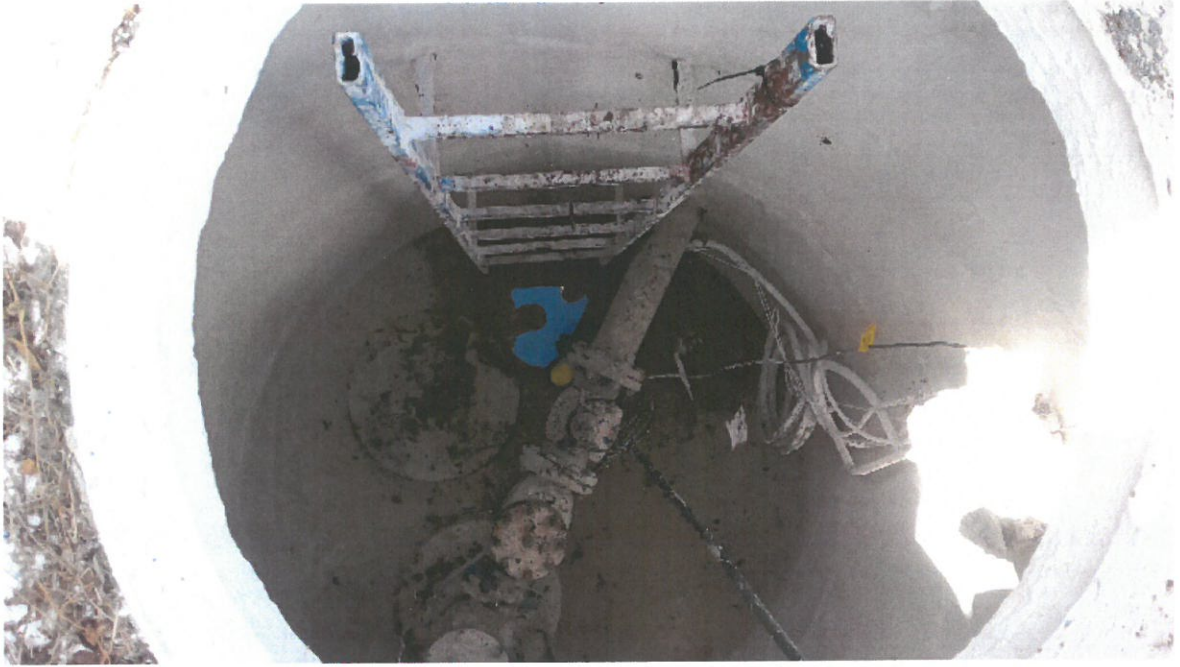
Zdjęcie nr 3 – Widok wnętrza studni głębinowej Nr 1.
