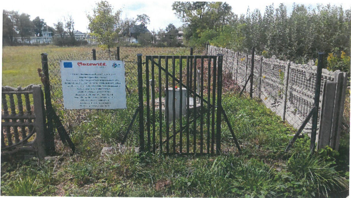
Zdjęcie nr 43– Pompownia.
