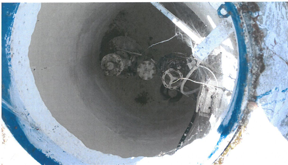
Zdjęcie nr 25 – Widok wnętrza studni głębinowej Nr 2.
