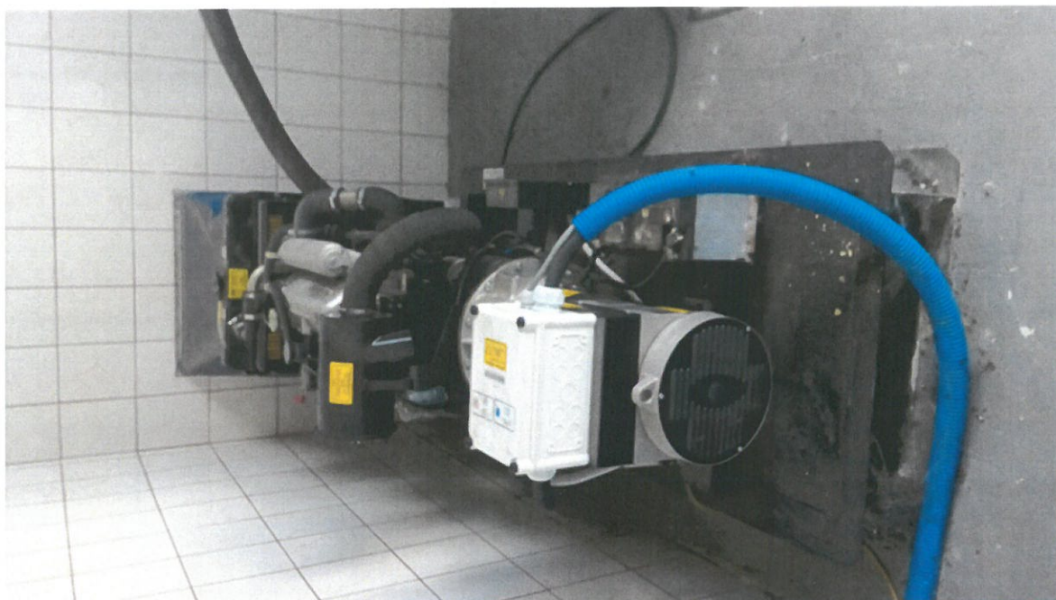
Zdjęcie nr 7 – Agregat prądowórczy.
