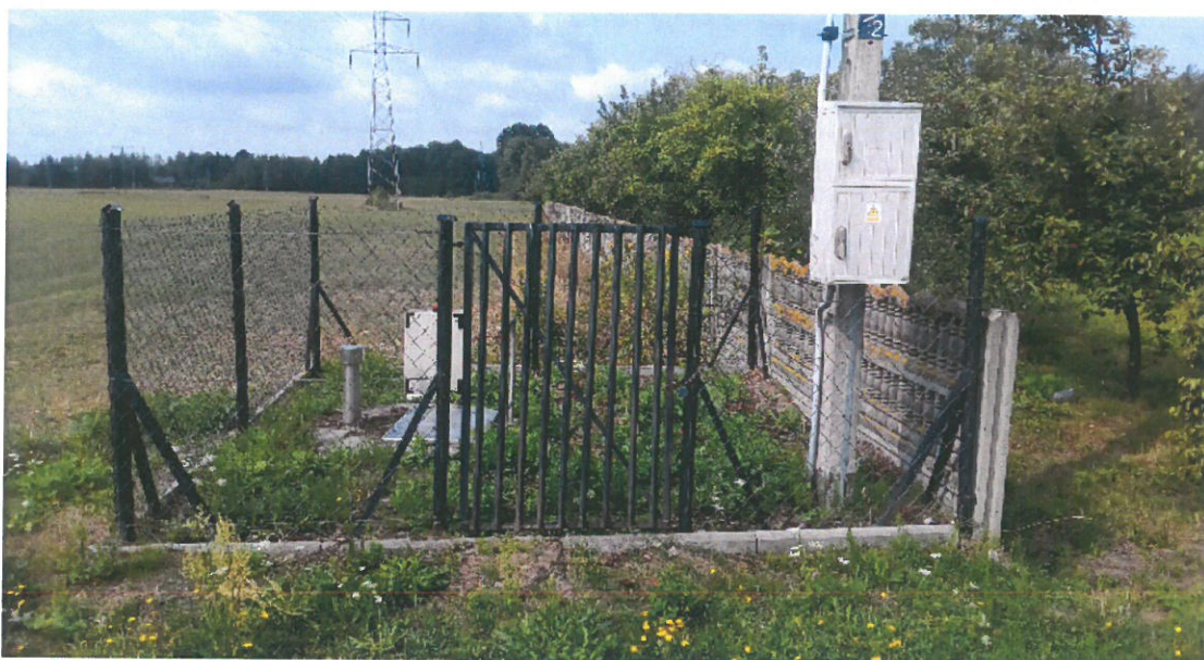
Zdjęcie nr 37 – Pompownia.
