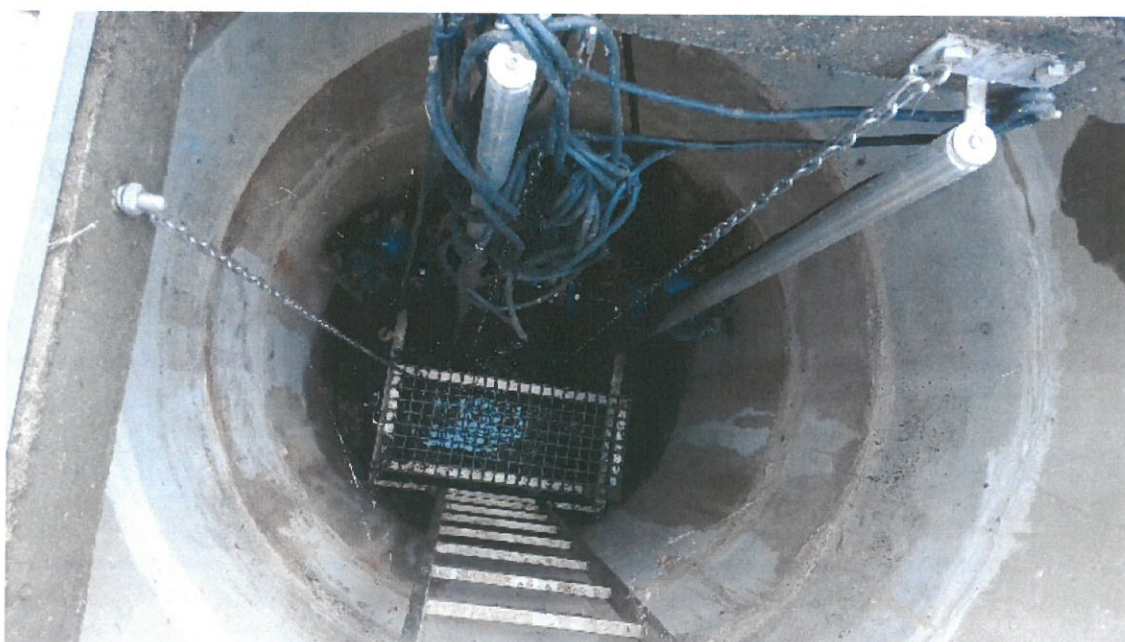
Zdjęcie nr 40 – Pompownia.
