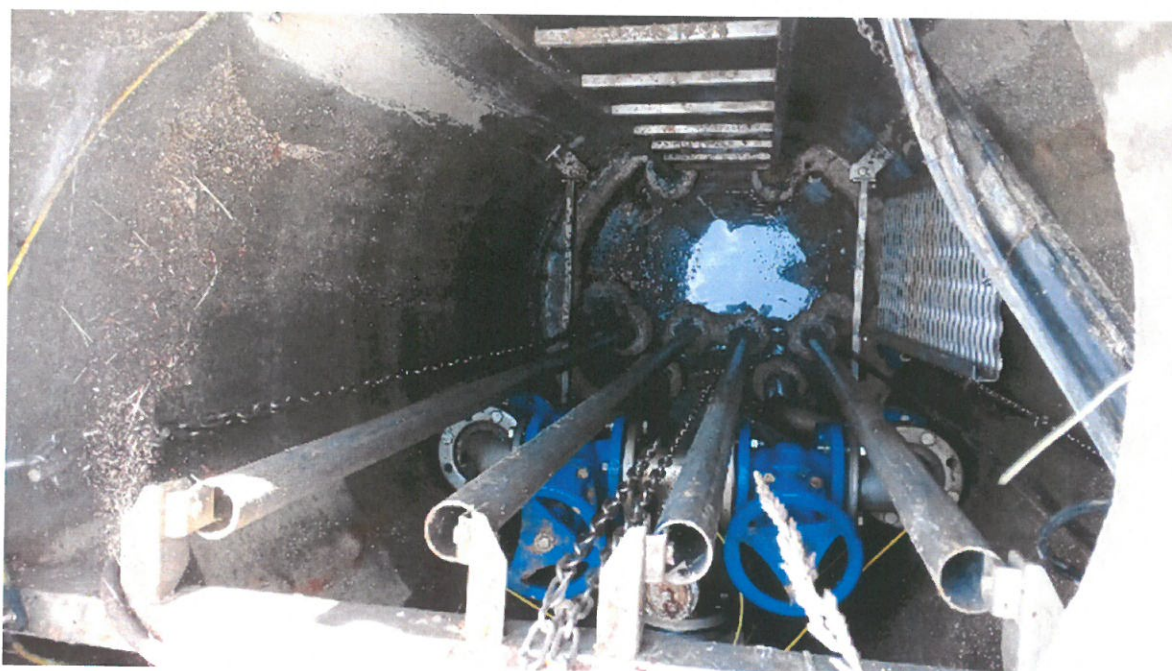
Zdjęcie nr 56 – Pompownia.
