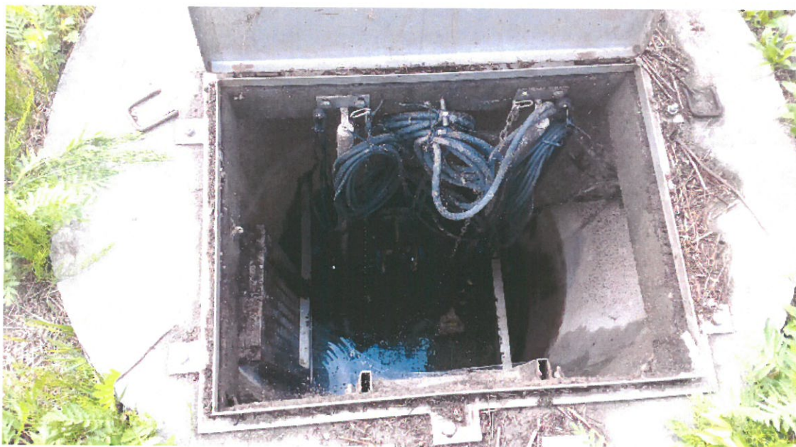
Zdjęcie nr 38 – Pompownia.
